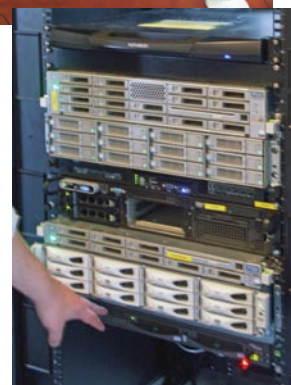
Umiejscowienie Kronosa w nowej serwerowni
