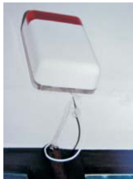
Fot. 1. Widok sygnalizatora i przewodów po włamaniu
